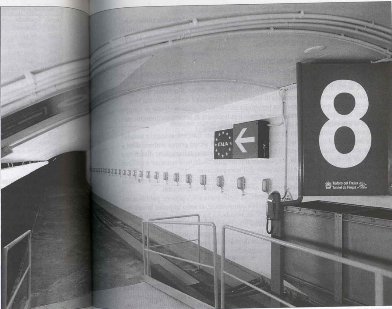
Particolare del condotto di ventilazione del traforo del Frejus, utilizzato come via di fuga in caso d'emergenza.
