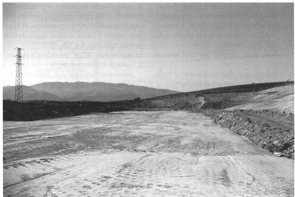
Foto 2 - Protesi presso l'imbocco nord: il materiale stabilizzato in posto. Photo 2 - Artificial ground overburden at the northern portal: the ground material compacted on site.
