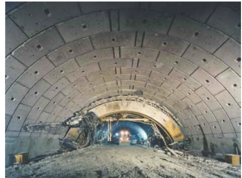
La macchina utilizzata per eseguire il pretaglio meccanico ed assemblare la volta di conci prefabbricati di c.a.p.
